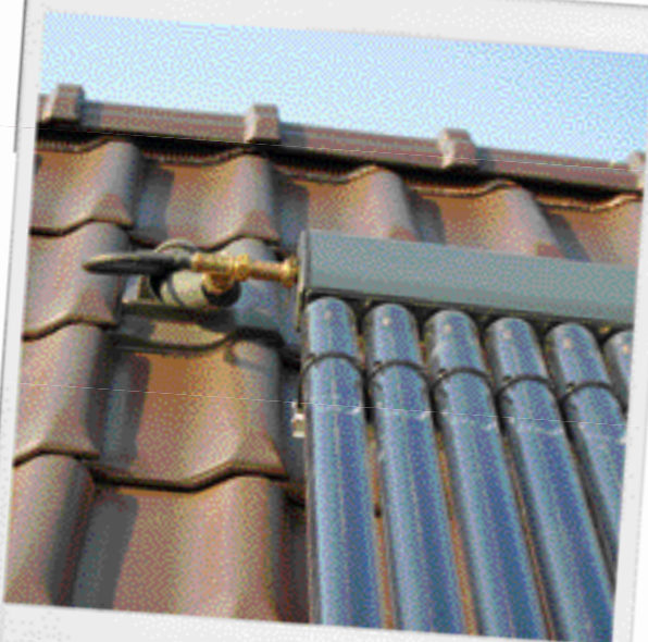
Zwei Vakuumröhrenkollektoren übernehmen in den Sommermonaten die Warmwasserversorgung.
